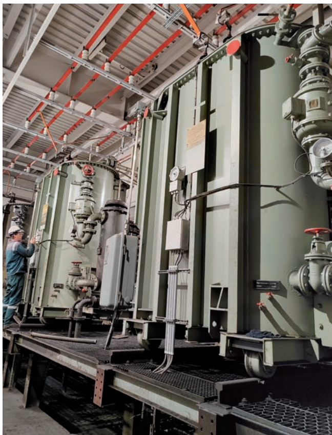
Transformátory pece EOP26
